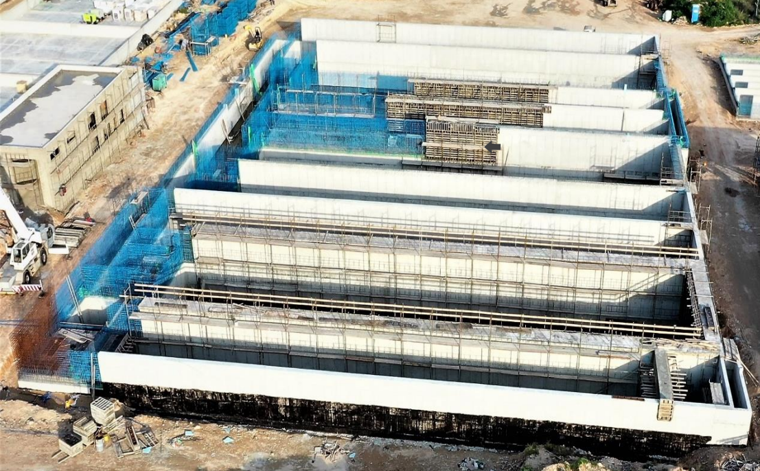
Εικόνα 3 – Δεξαμενές δευτεροβάθμιας επεξεργασίας
